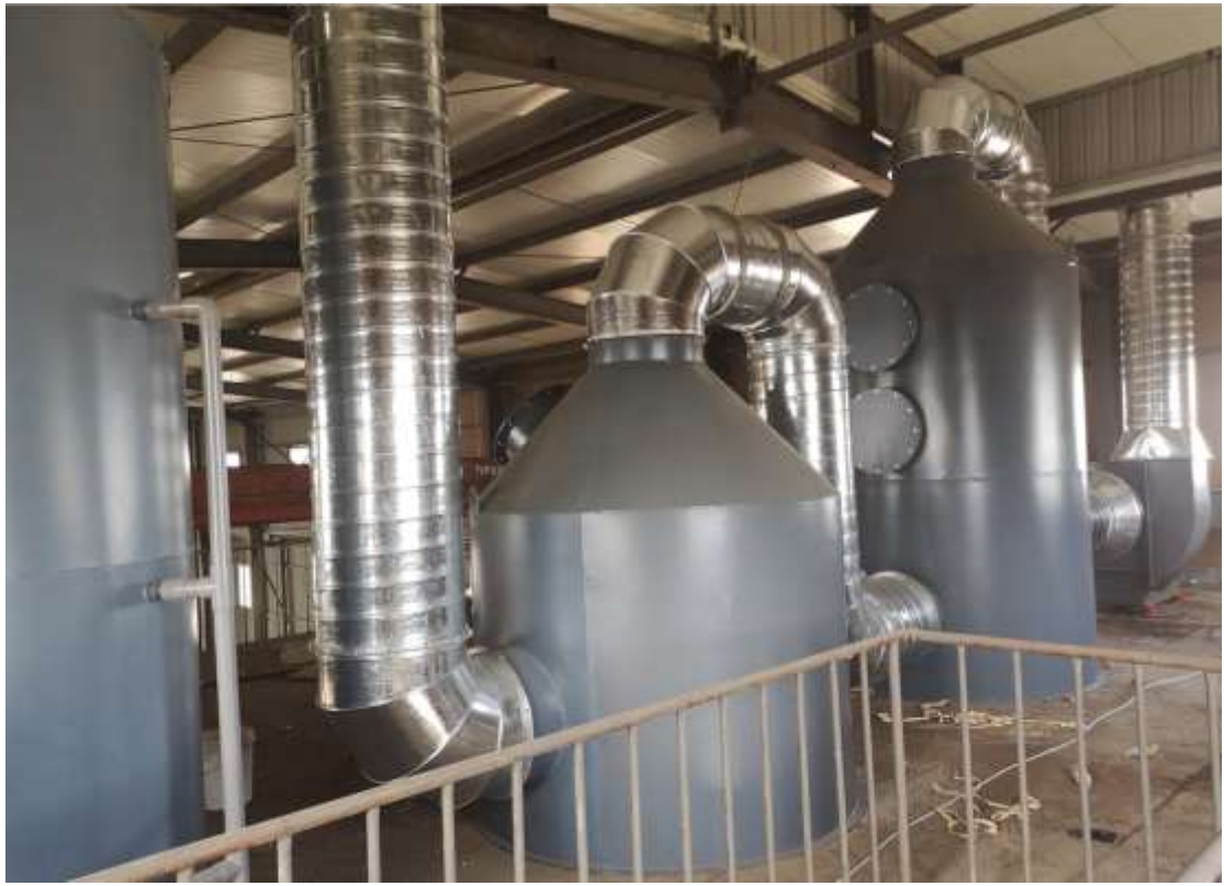
废气处理装置
