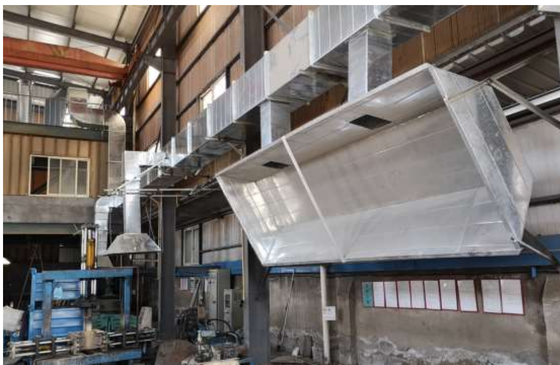
废气收集装置
