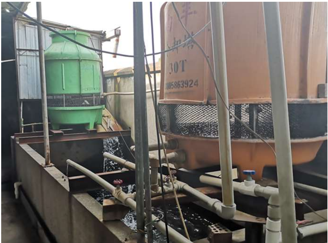
冷取水循环装置
