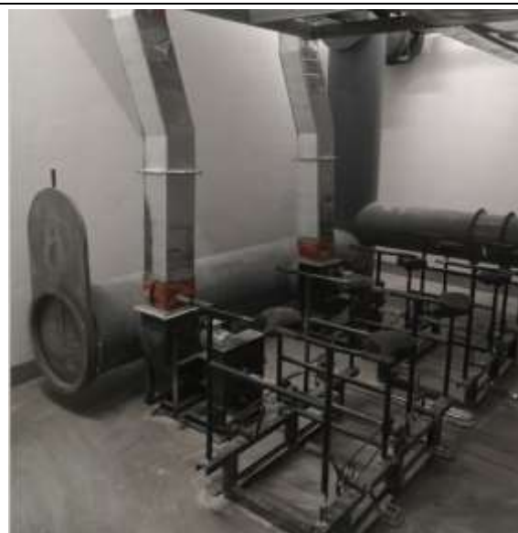
地下室排气风机
