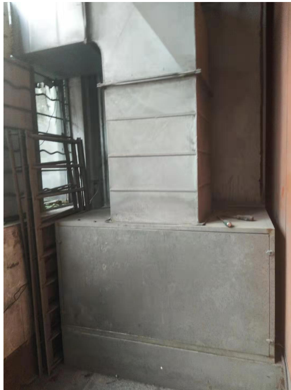
图 3-2 废气处理设施图
