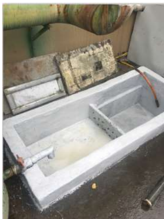
喷淋水循环设施
