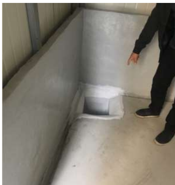
危废场所泄漏收集
