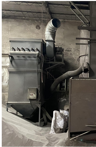
图 3-1 废气处理设备
