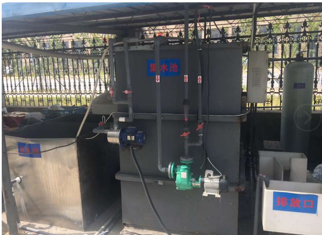
废水处理设施
