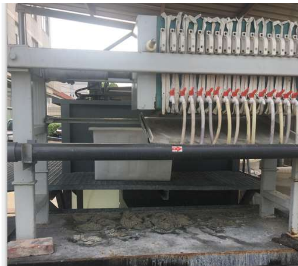
污泥压滤装置
