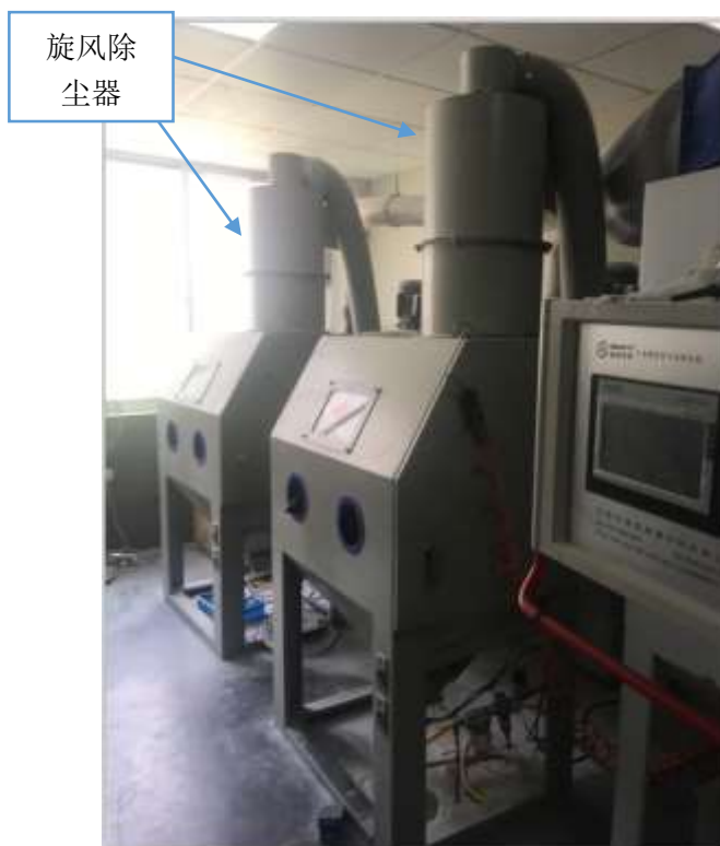
喷砂废气处理设施
