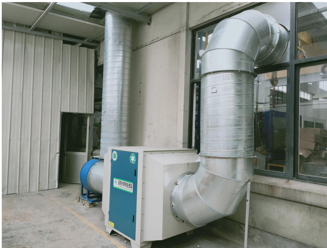
废气处理设施图
