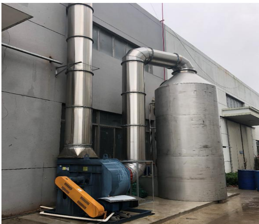
图 3-6 熔化烟尘、脱模废气、天然气燃烧废气处理设施图
