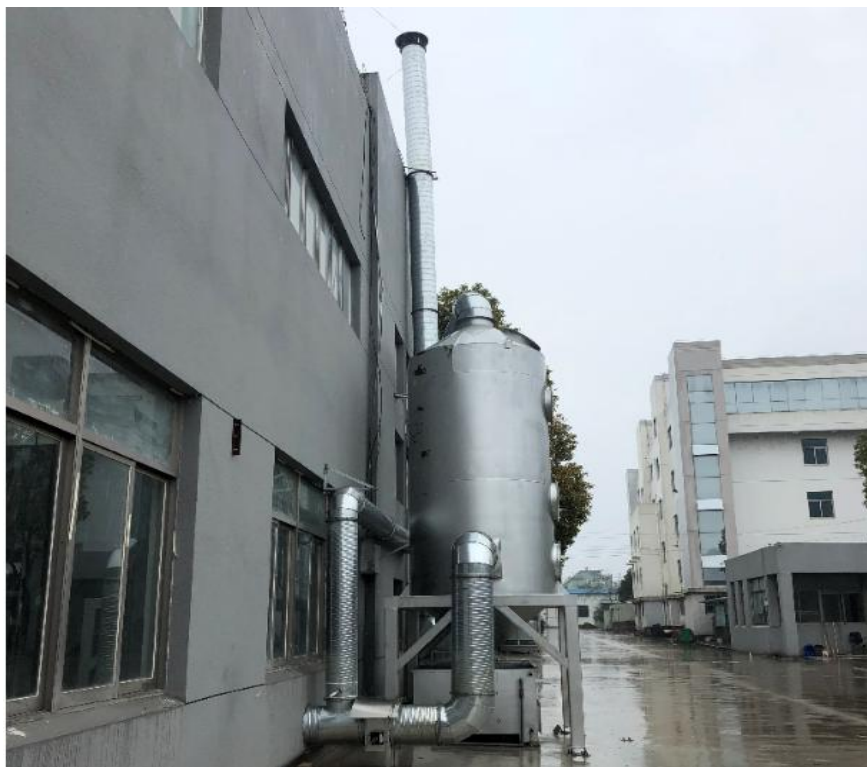
图 3-8 打磨废气处理设施图
