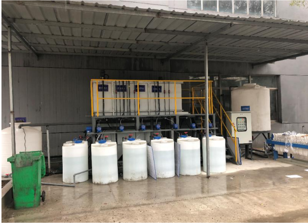
图 3-2 清洗废水处理设施图
