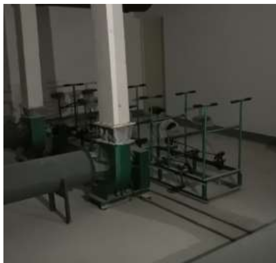
地下室排气风机
