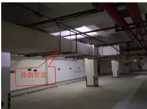
地下室排烟管道
