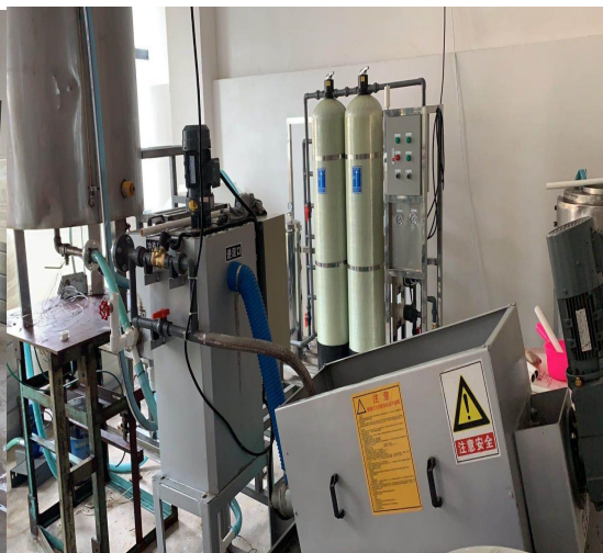
一级清洗废水处理区
