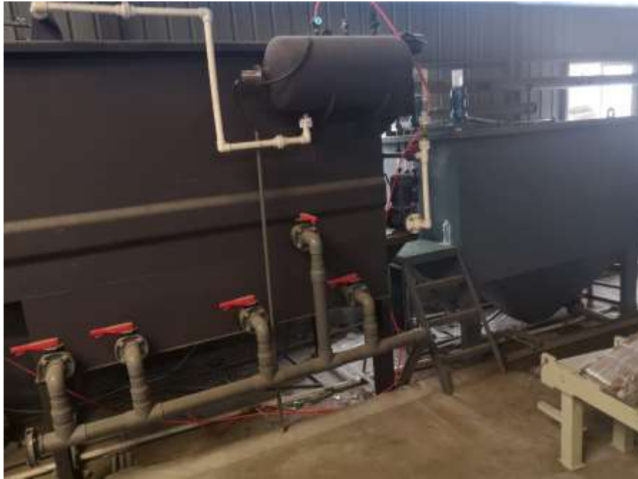
废水处理设施
