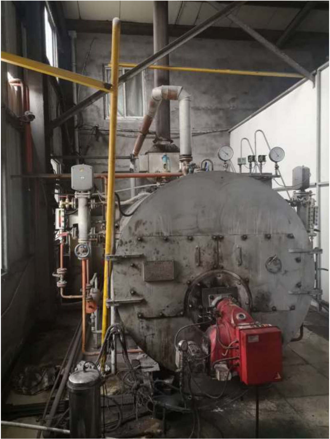
企业燃油锅炉
