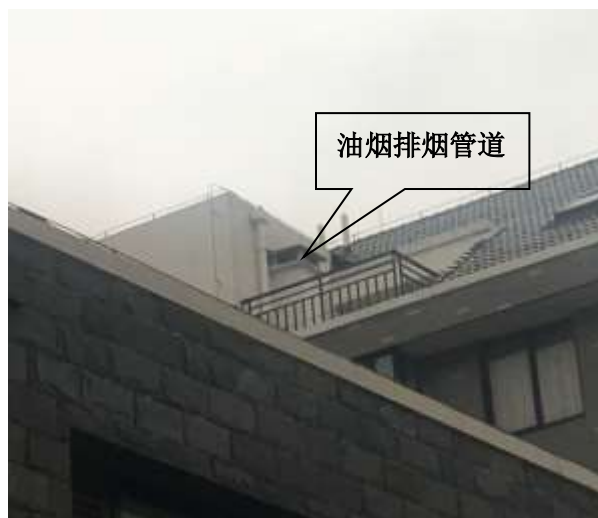
居民油烟排放管道
