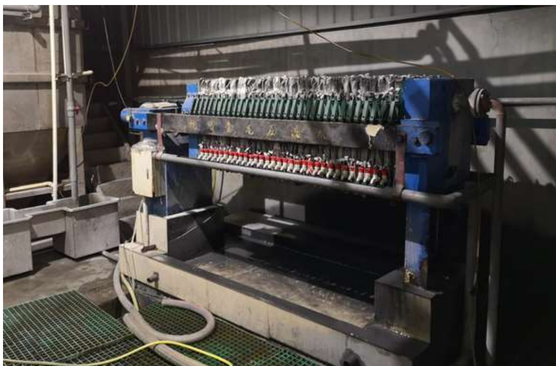
废水压滤装置
