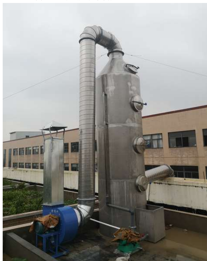
淬火、渗碳渗氮废气处理设施
