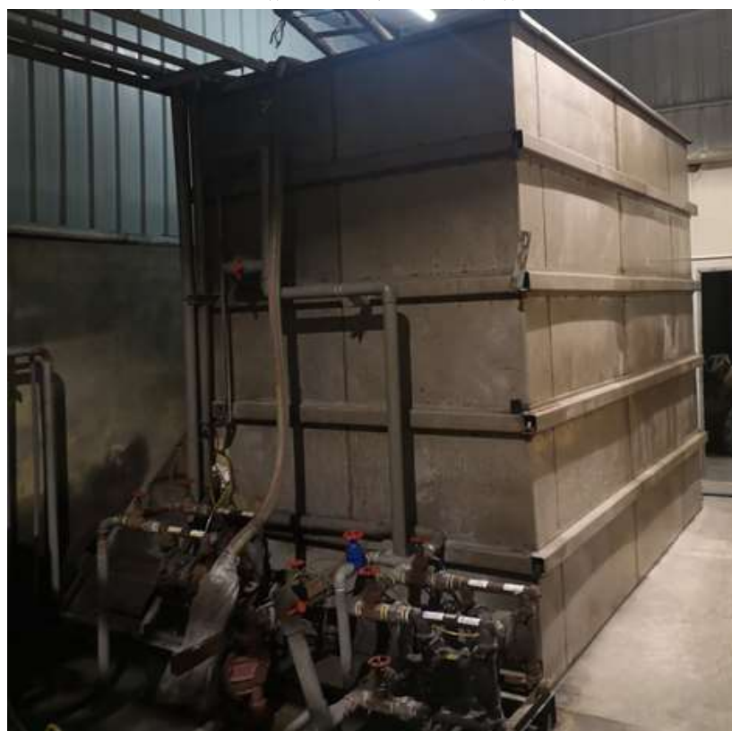
生产废水絮凝沉淀设施
